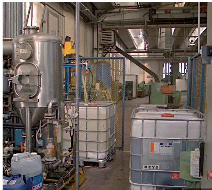
Impianto di controllo e gestione dell'emulsione preparata con "Lubrorefrigerante F1".
